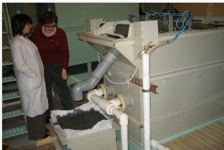
Рис. 2. Электрофлотатор на ФГУП «Уральский электромеханический завод» (Екатеринбург)
