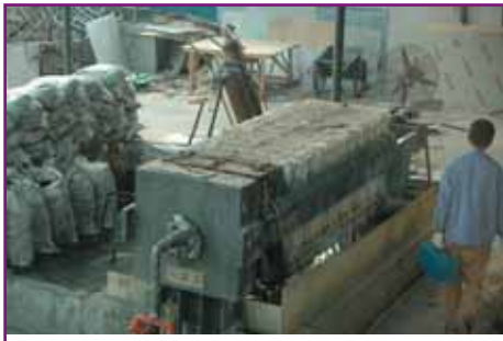
Рис. 5. Одна из установок водоочистки
